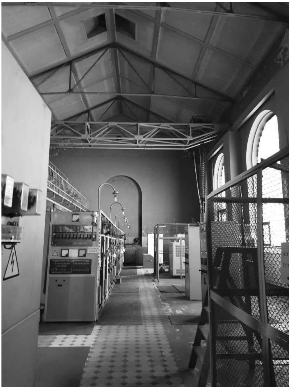
16. Выявленный объект культурного наследия «Полюстровская трамвайная подстанция», Санкт-Петербург, Полюстровский пр., д.4, лит.А. Машинный зал (пом. 11, 1-й эт.).
