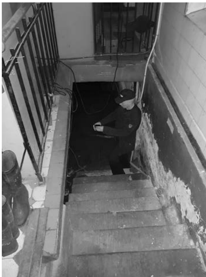
18. Выявленный объект культурного наследия «Полюстровская трамвайная подстанция», Санкт-Петербург, Полюстровский пр., д.4, лит.А. Машинный зал (пом. 11, 1-й эт.) Сход в техническое подполье.
