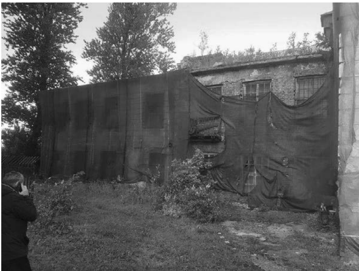
6. Выявленный объект культурного наследия «Полуостровская трамвайная подстанция», Санкт-Петербург, Полуостровский пр., д.4, лит.А. Фрагмент восточного фасада.
