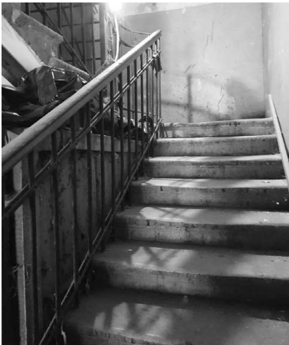
25. Выявленный объект культурного наследия «Полюстровская трамвайная подстанция», Санкт-Петербург, Полюстровский пр., д.4, лит.А. Лестница 4-Н.
