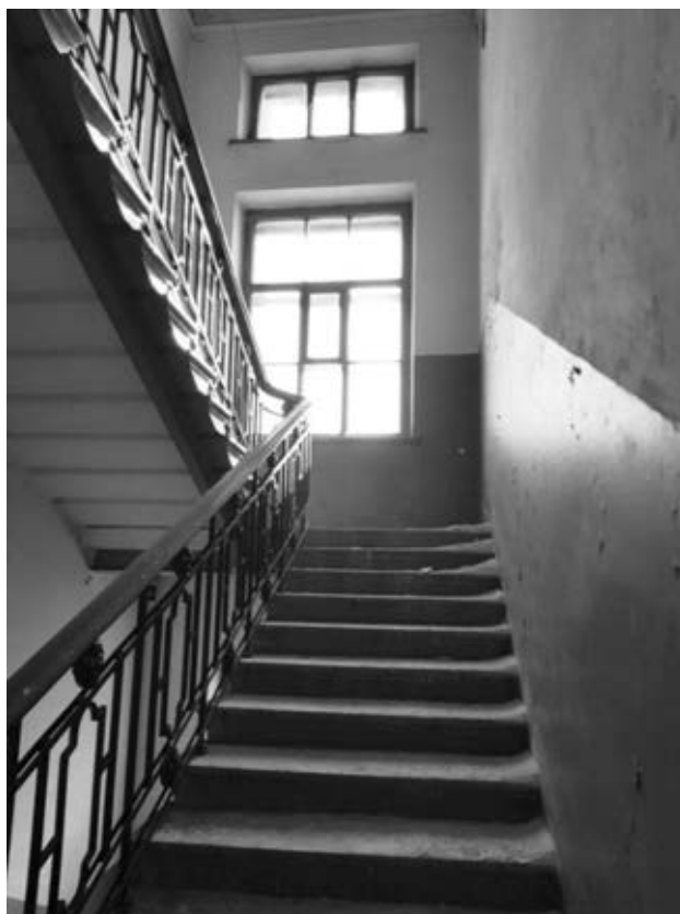
14. Выявленный объект культурного наследия «Полюстровская трамвайная подстанция», Санкт-Петербург, Полюстровский пр., д.4, лит.А. Конструкции лестницы 1-Н.
