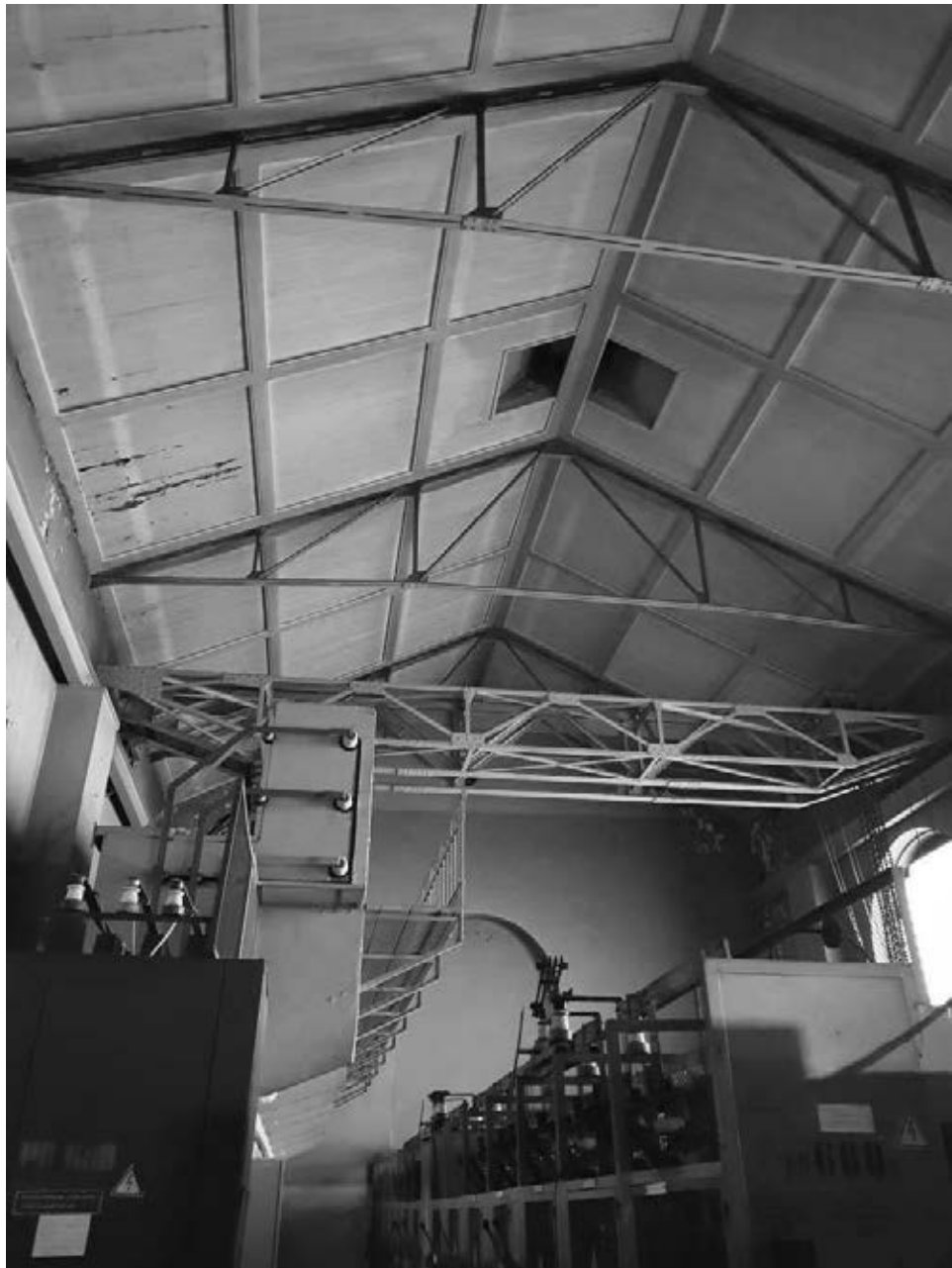
17. Выявленный объект культурного наследия «Полюстровская трамвайная подстанция», Санкт-Петербург, Полюстровский пр., д.4, лит.А. Машинный зал (пом. 11, 1-й эт.).
