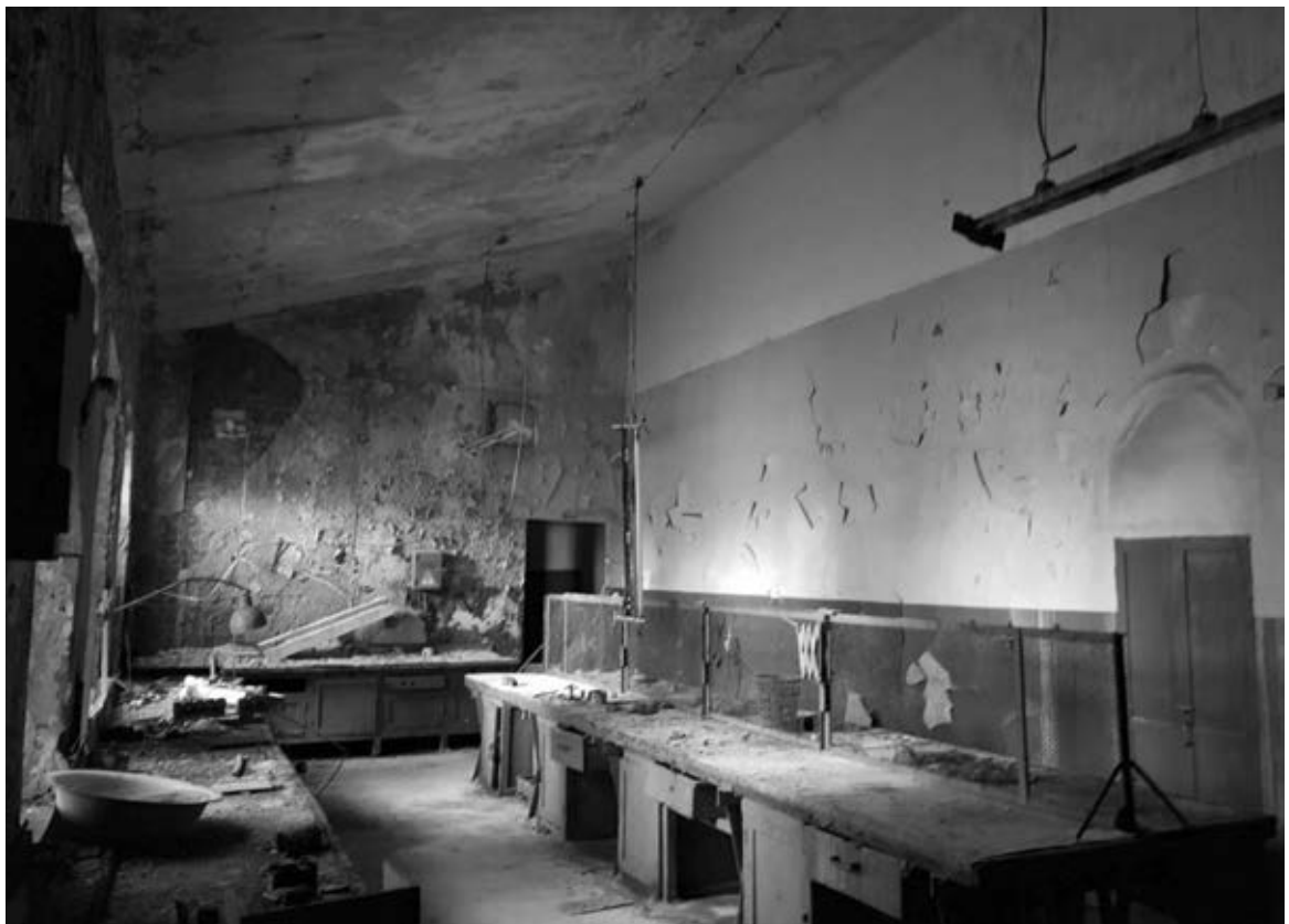
22. Выявленный объект культурного наследия «Полюстровская трамвайная подстанция», Санкт-Петербург, Полюстровский пр., д.4, лит.А. Слесарные мастерские (пом. 31, 2-й эт.)
