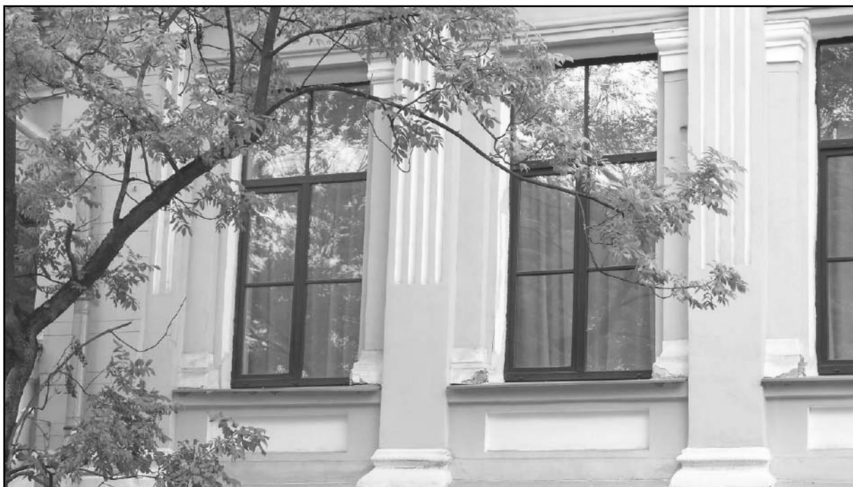
Фото 3. Лицевой фасад. Фрагмент. Окна второго этажа ОК-2. Окна заменены на металлопластиковые
