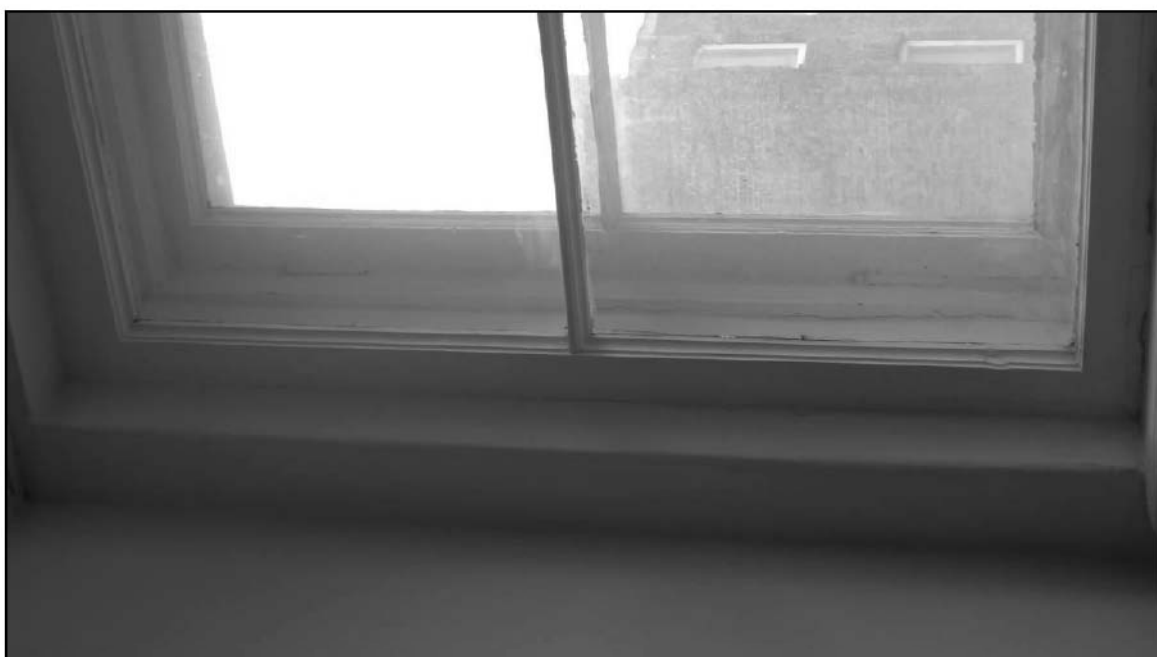
Фото 21. Окно ОК-6. Фрагмент. Сохранившаяся деревянная рама
